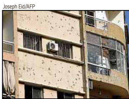
Alguns prédios ficaram crivados de balas
