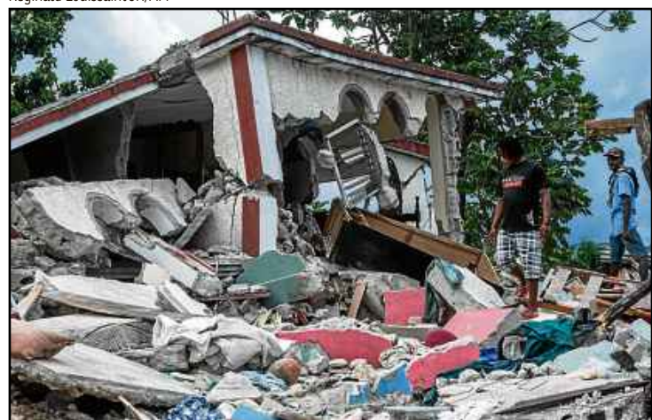
Casa transformada em ruínas pelo terremoto de sábado, em Camp-Perrin
