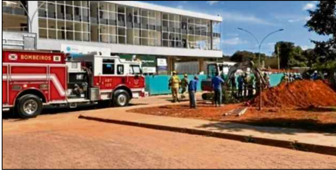
Acidente em uma vala, ontem, na quadra CLNW 8/9, no Noroeste, resultou na morte de um trabalhador
