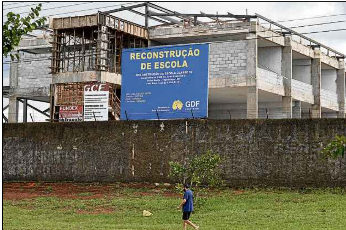
Em Taguatinga Norte, as obras de reconstrução na Escola Classe 52 na QNM 38 já começaram
